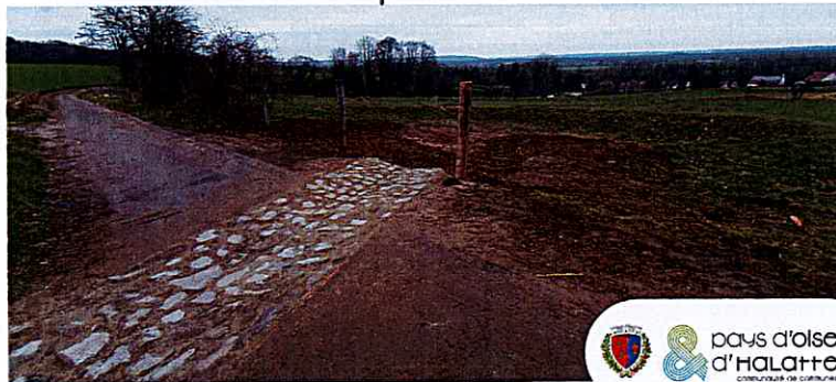
Commune de Pontpoint : mare tampon alimentée par un passage à gué
